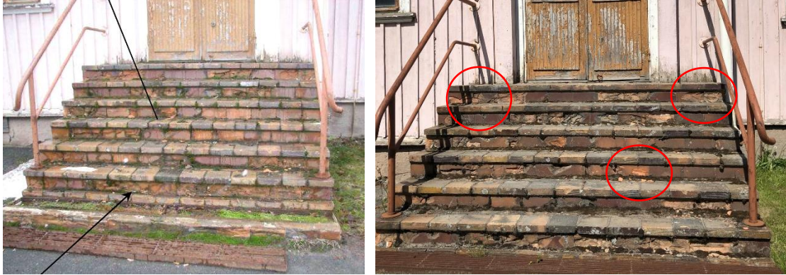
Kuva 27. Vasemmalla kuva kuntotutkimuksessa (Drytec, 2014) kuvatusista poirtaikosta, oikealla vuonna 2021. Pakkasvauriot ovat edenneet. Lisääntyneitten vauriokohtia on merkitty punaisella ympyrällä.
