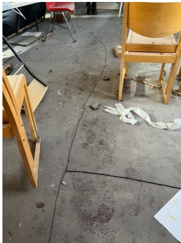
Lattian halkeama ruokasalissa (kuvausaika 05/2023 Heidi Hulkki).
