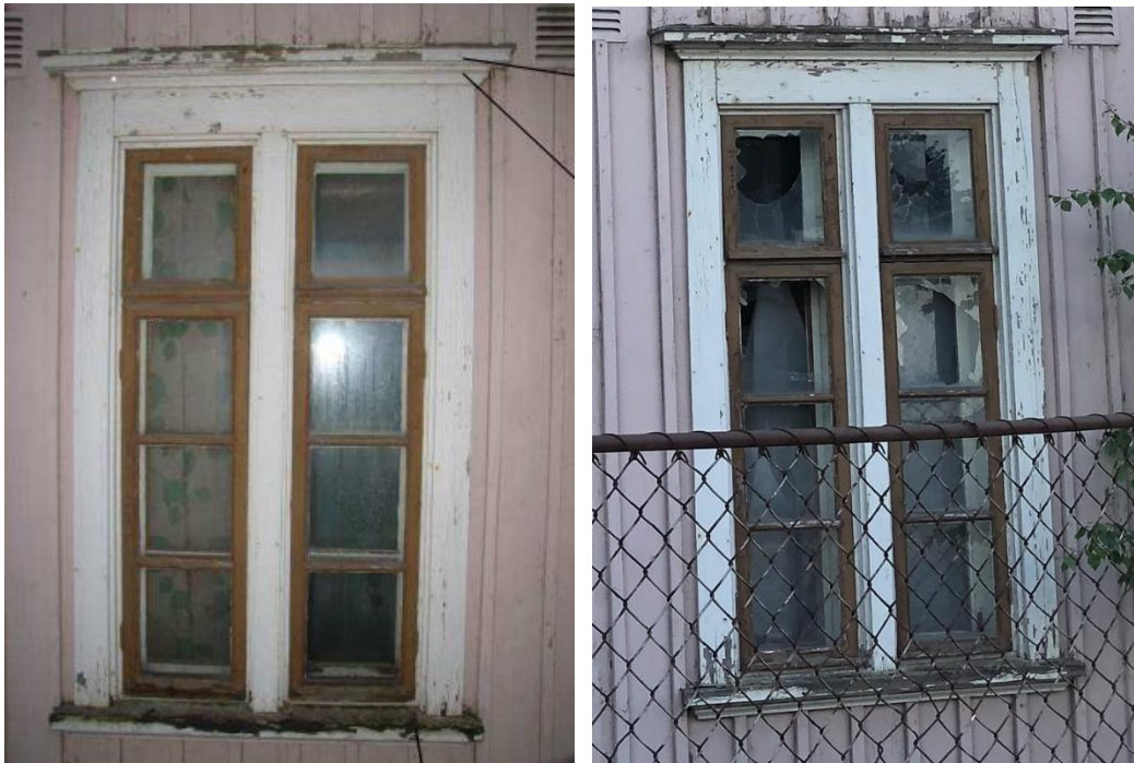
Kuva 29. Vasemmalla kuva kuntotutkimuksessa (Drytec, 2014) kuvatusista ikkunasta, oikealla vuonna 2021. Puuosien kunto on heikentynyt ja ikkunaruuudut on rikottu.
