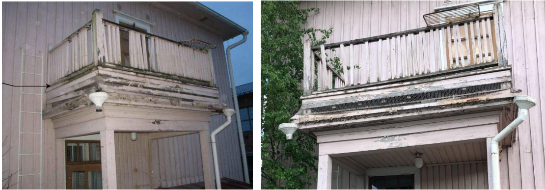
Kuva 28. Vasemmalla kuva kuntotutkimuksessa (Drytec, 2014) kuvatusista kaiteesta, oikealla vuonna 2021. Kaiderimoitus on harventunut ja laudoitusta on korvattu verkolla.
