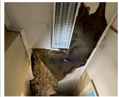
Vioittunutta kattoa käytävän päässä. (kuvausaika 05/2023 Heidi Hulkki).
